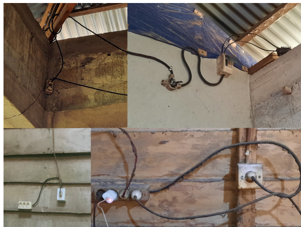
Gambar 2. Beberapa bentuk instalasi terpasang di rumah warga
