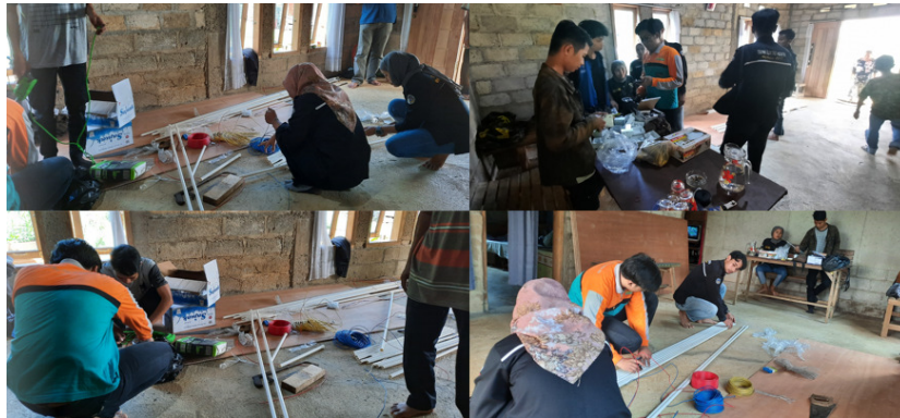
Gambar 3. Tim pelaksana kegiatan sedang menyiapkan komponen instalasi untuk dipasang Pada gambar 3 terlihat semua tim pelaksana kegiatan sedang mempersiapkan semua komponen instalasi listrik yang akan dipasang di rumah warga
